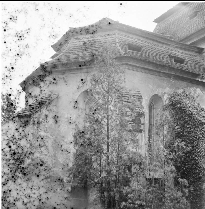
Presbytář v pohledu od severovýchodu. Foto: 1963, sbírka negativů NPÚ ÚOP v Ústí n. L., sig. 8554.
